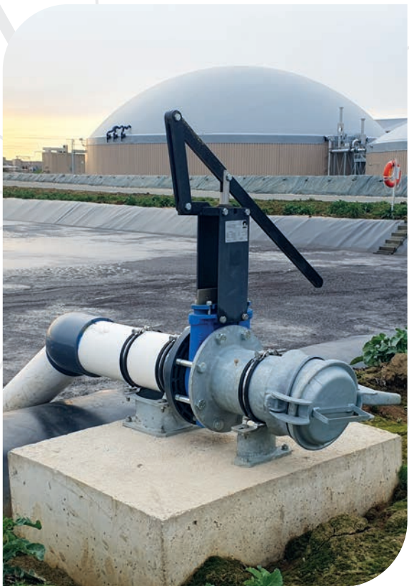
Vanne guillotine sur réseau pompage Digestat
